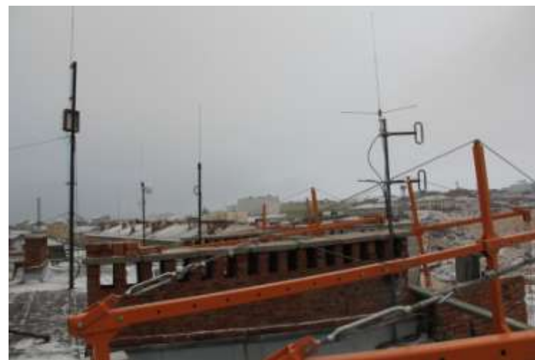
МСКЦ Антенны ПВ/КВ, УКВ на крыше здания
